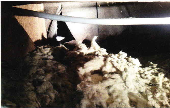
Das Einstiegsloch eines Marders. Die Dachdämmung wurde komplett zerlegt.
